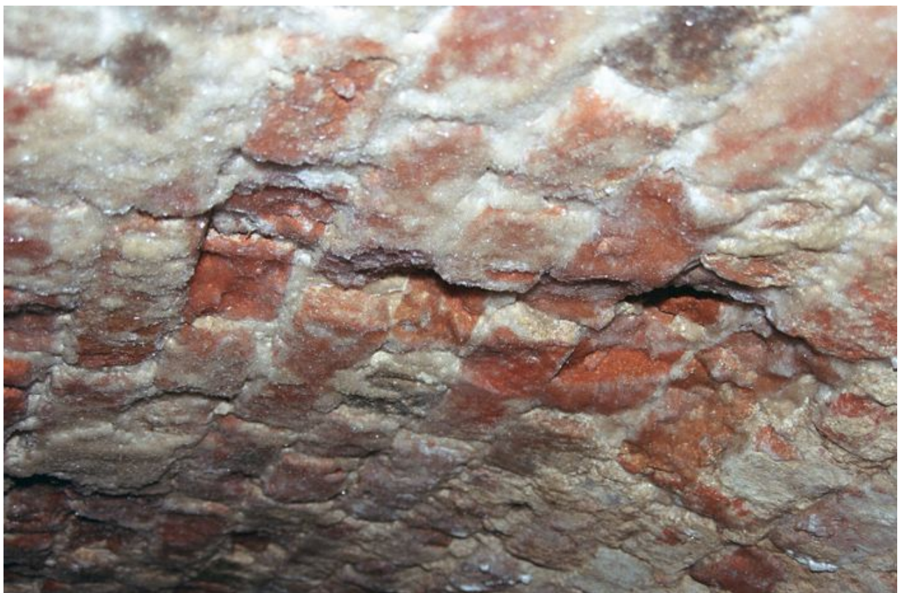
Foto 13. Poterni nr. 4 idapoolse ruumi jäätunud lagi.
