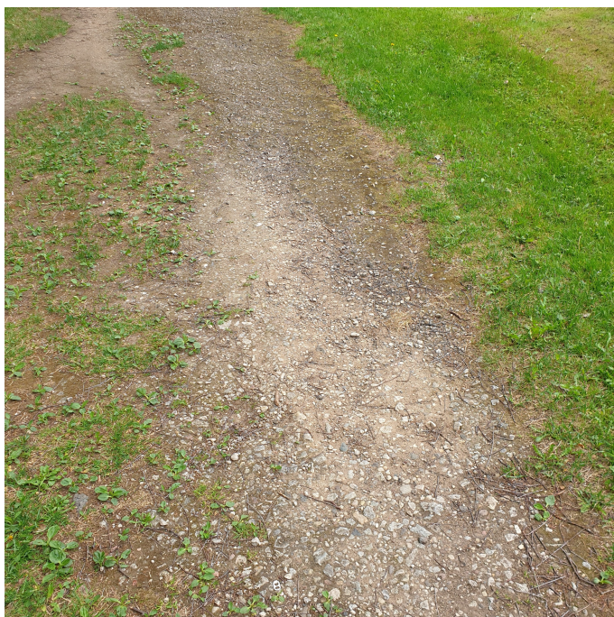
Foto nr 2. Raamatukogu kõrval asuva raja lagunenud asfalt (Autori foto)
