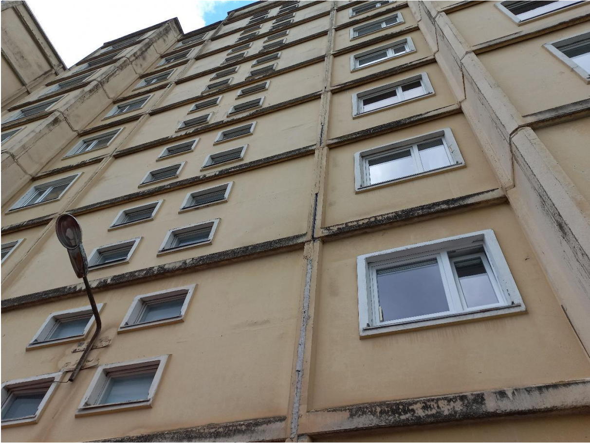
Joonis 2.2 Välisseina vuukide olukord. Foto: Tamur Tensing / TREA 18.07.2022 a
