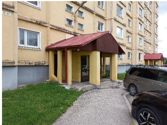
Joonis 2.4 Tuulekoja olukord. Foto: Tamur Tensing / TREA 18.07.2022 a
