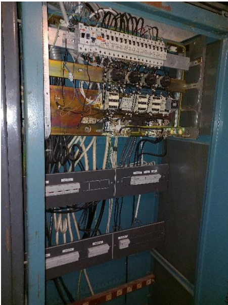
Joonis 2.10 Elektrikilbi olukord. Foto: Tamur Tensing / TREA 19.07.2022 a
