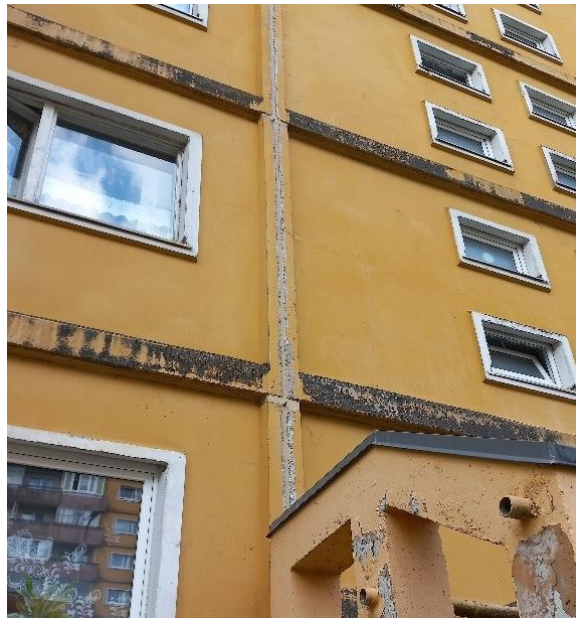
Joonis 2.3 Välisseina vuukide olukord. Foto: Tamur Tensing / TREA 25.07.2022 a.
