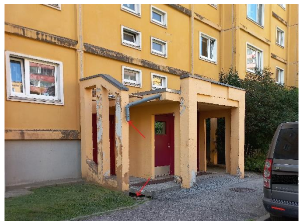
Joonis 2.5 Tuulekoja olukord. Foto: Tamur Tensing / TREA 25.07.2022 a.
