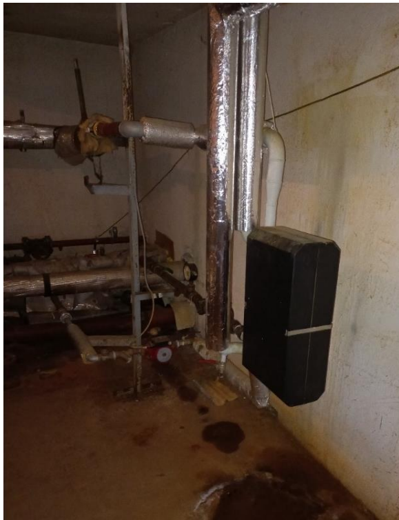
Joonis 2.8 Soojussõlme olukord. Foto: Tamur Tensing / TREA 25.07.2022 a.
