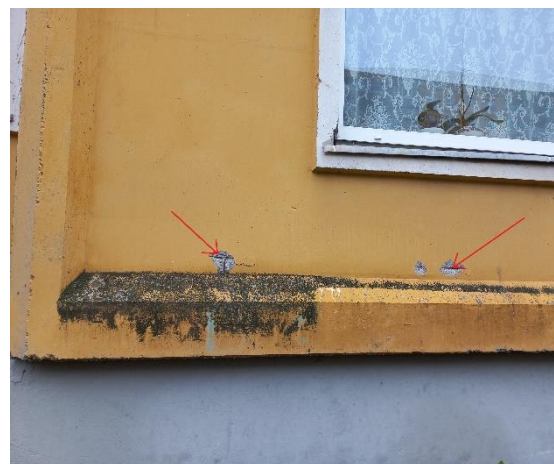
Joonis 2.2 Hoone fassaadi kahjustused. Foto: Tamur Tensing / TREA 25.07.2022 a.
