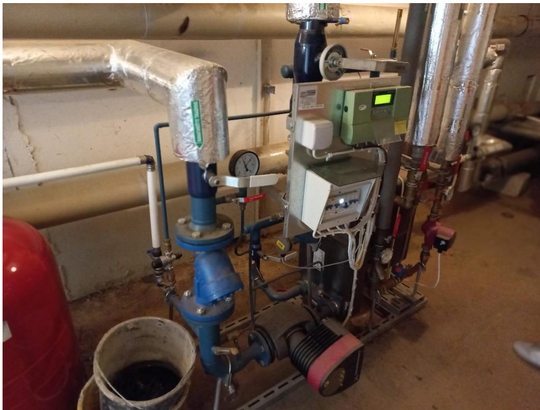
Joonis 2.10 Soojussõlme olukord. Foto: Tamur Tensing / TREA 19.07.2022 a.
