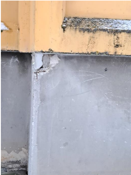
Joonis 2.3 Hoone fassaadi kahjustused. Foto: Gerli Alasoo /TREA 30.11.2022.a
