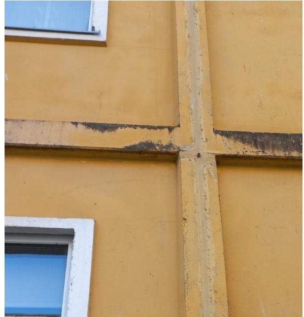
Joonis 2.4 Välisseina vuukide olukord. Foto: Tamur Tensing / TREA 20.07.2022 a.
