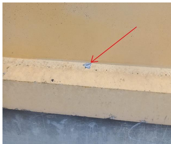
Joonis 2.2 Hoone fassaadi kahjustused. Foto: Tamur Tensing / TREA 20.07.2022 a.
