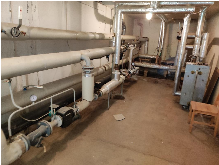
Joonis 2.11 Soojussõlme olukord. Foto: Martin Kikas / TREA 20.07.2022 a.
