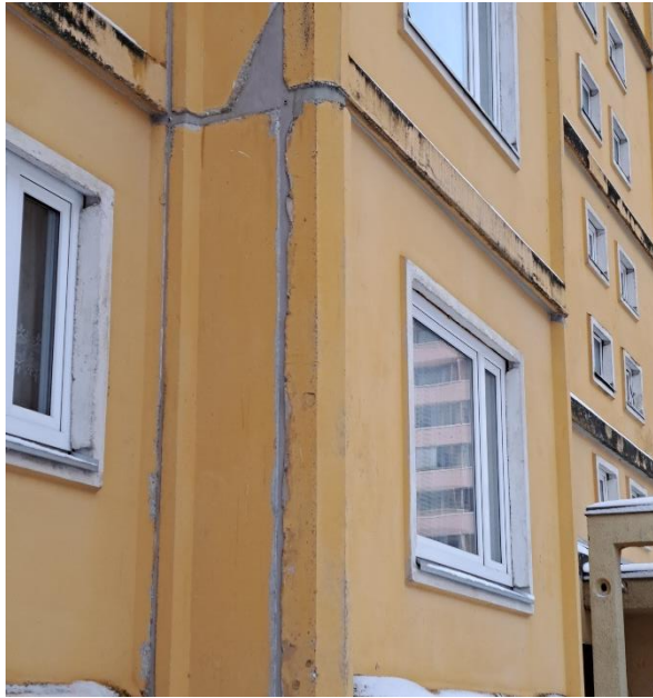
Joonis 2.3 Välistseina vuukide olukord. Foto: Gerli Alasoo / TREA 30.11.2022 a
