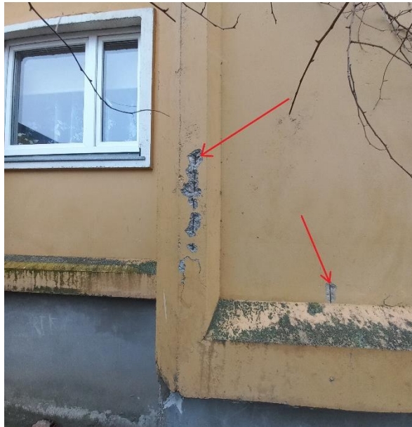
Joonis 2.2 Fassaadi olukord. Foto: Tamur Tensing / TREA 19.07.2022 a
