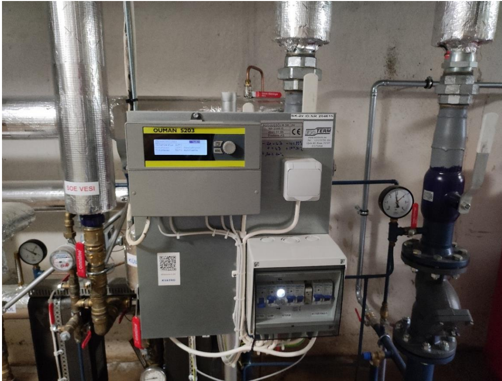
Joonis 2.9 Soojussõlme olukord. Foto: Martin Kikas / TREA 19.07.2022 a
