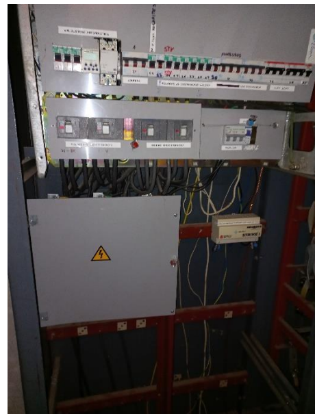
Joonis 2.12 Elektrikilbi olukord. Foto: Tamur Tensing / TREA 14.07.2022 a
