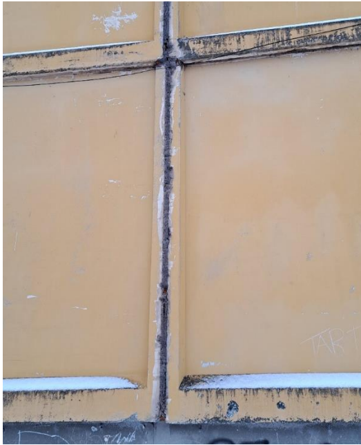
Joonis 2.2 Välisseina vuukide olukord. Foto: Gerli Alasoo / TREA 30.11.2022 a.
