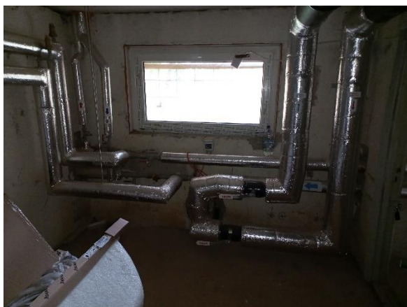
Joonis 2.8 Kütetorustike olukord. Foto: Tamur Tensing / TREA 19.07.2022. a
