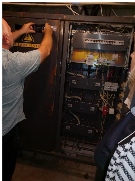
Joonis 2.11 Elektrikilbi olukord. Foto: Tamur Tensing / TREA 19.07.2022 a
