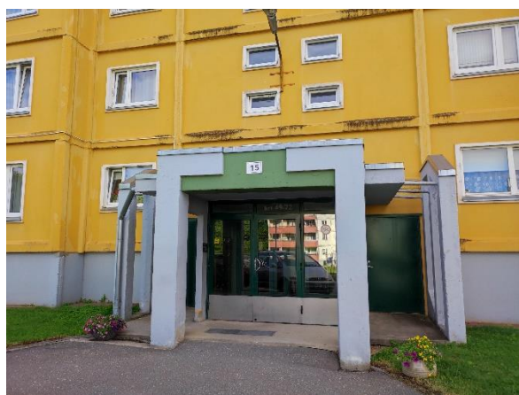
Joonis 2.4 Tuulekoja olukord. Foto: Martin Kikas / TREA 15.07.2022 a
