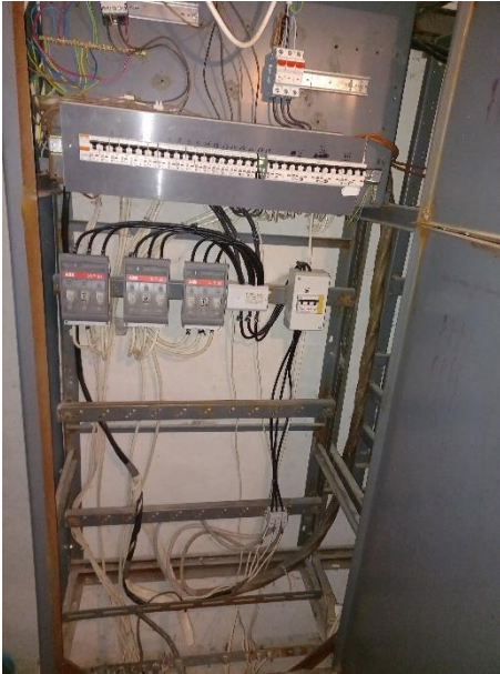
Joonis 2.9 Elektrikilbi olukord. Foto: Tamur Tensing / TREA 15.07.2022 a
